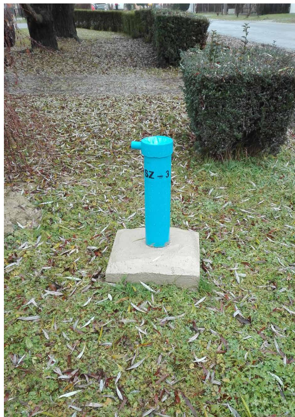
TALAJVIZES MONITORING KÚT FOTÓ: AQUAPINKA
